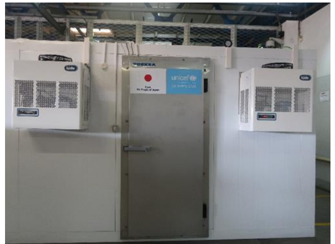
（写真）供与した機材（ウォークイン冷蔵庫）
